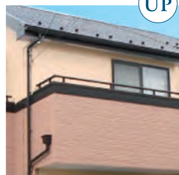
窓枠やベランダの取っ手などの 雨の跡が付きやすい部分が汚れていません。
